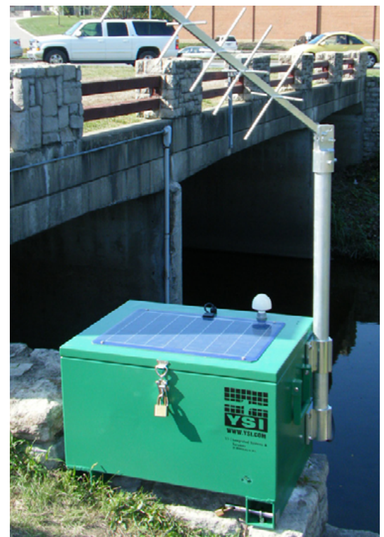
Ce site portable pour la qualité de l'eau de pluie au Kansas est équipé d'un panneau solaire et est capable de collecter des données, de télémétrie, de qualité de l'eau, de MET ou de débit dans des applications robustes.
