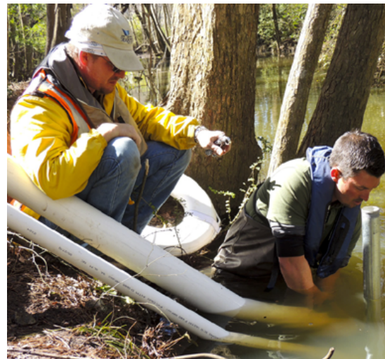
Des techniciens de terrain d'YSI installent des boîtiers de protection pour une sonde de qualité de l'eau EXO et une ligne d'aspiration d'échantillonneur d'eau discret.
