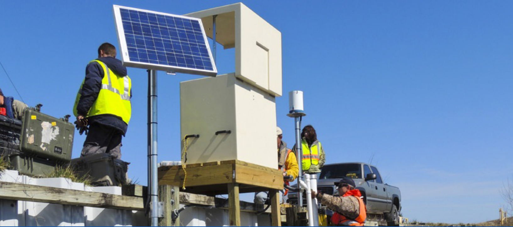
L'équipe des services sur le terrain d'YSI finalisant l'installation d'un site complet de gestion des eaux pluviales en Caroline du Nord.
