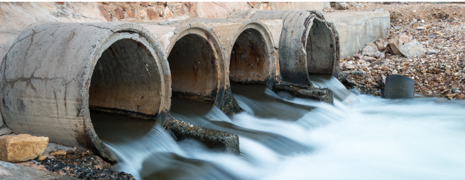
Déversement des eaux pluviales
