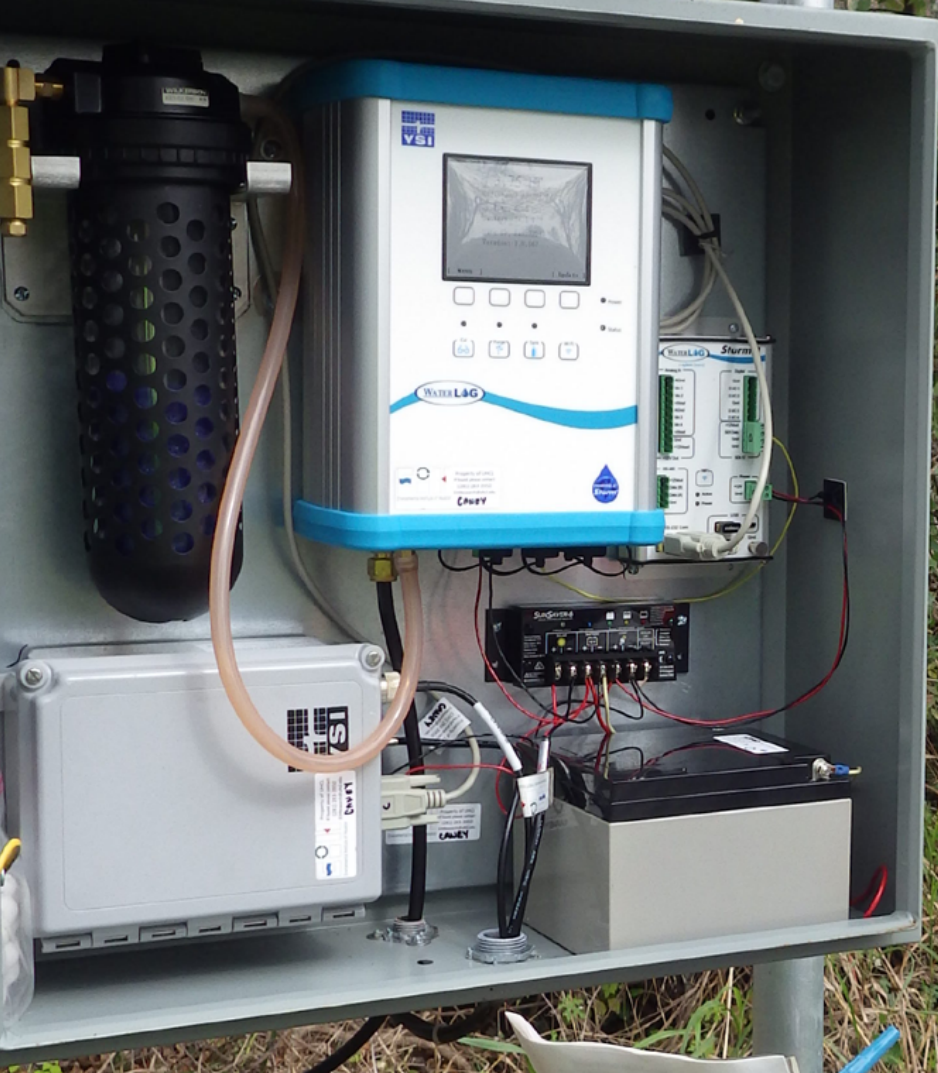
Une solution complète de gestion des eaux pluviales comprenant Le Bulleur Amazon et l'enregistreur de données WaterLOG Storm 3 dans une station de surveillance au Texas.
